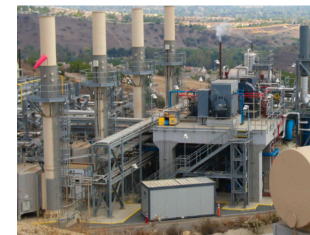
Brea 32MW California, USA
